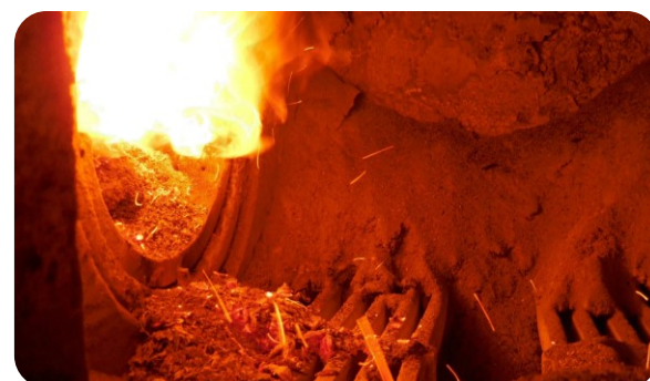
Combustion du saule en chaudière bois déchiqueté
